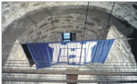
Im Hagelturm: Das Geländer im Turm muss an mehreren Stellen nachgebessert oder ausgetauscht werden. Der Förderverein Mündener Altstadt kümmert sich um einen Ersatz für diese Stahltrössen, die im Treppenhaus Besucher vor dem Sturz in den Schacht schützen sollen.
