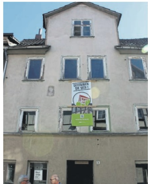
Das Objekt: Das Haus an der Siebenturmstraße 5 stand mehrere Jahre leer, jetzt gehört es der Bürgergenossenschaft Müндener Altstadt.
